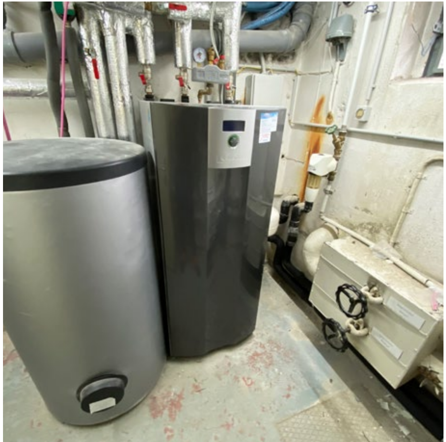
Altes Haus, neue Heizung: Wärmepumpe mit Warmwasserspeicher links daneben
